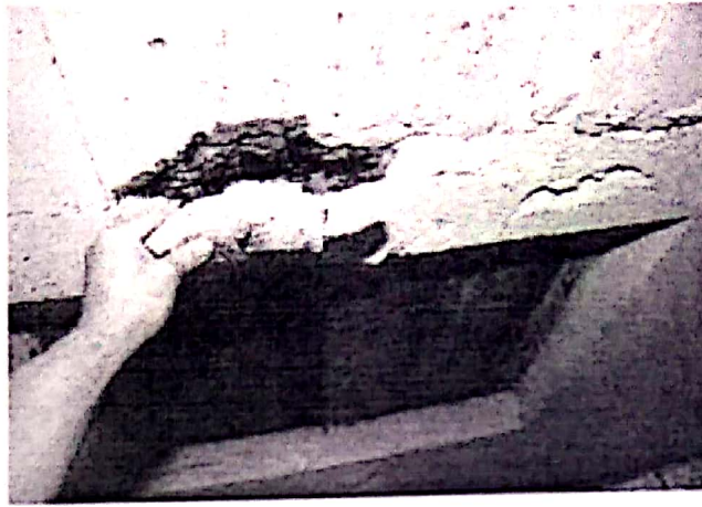
Figure 2 : Délamination (chute de plaque) d'ouvrage en béton
